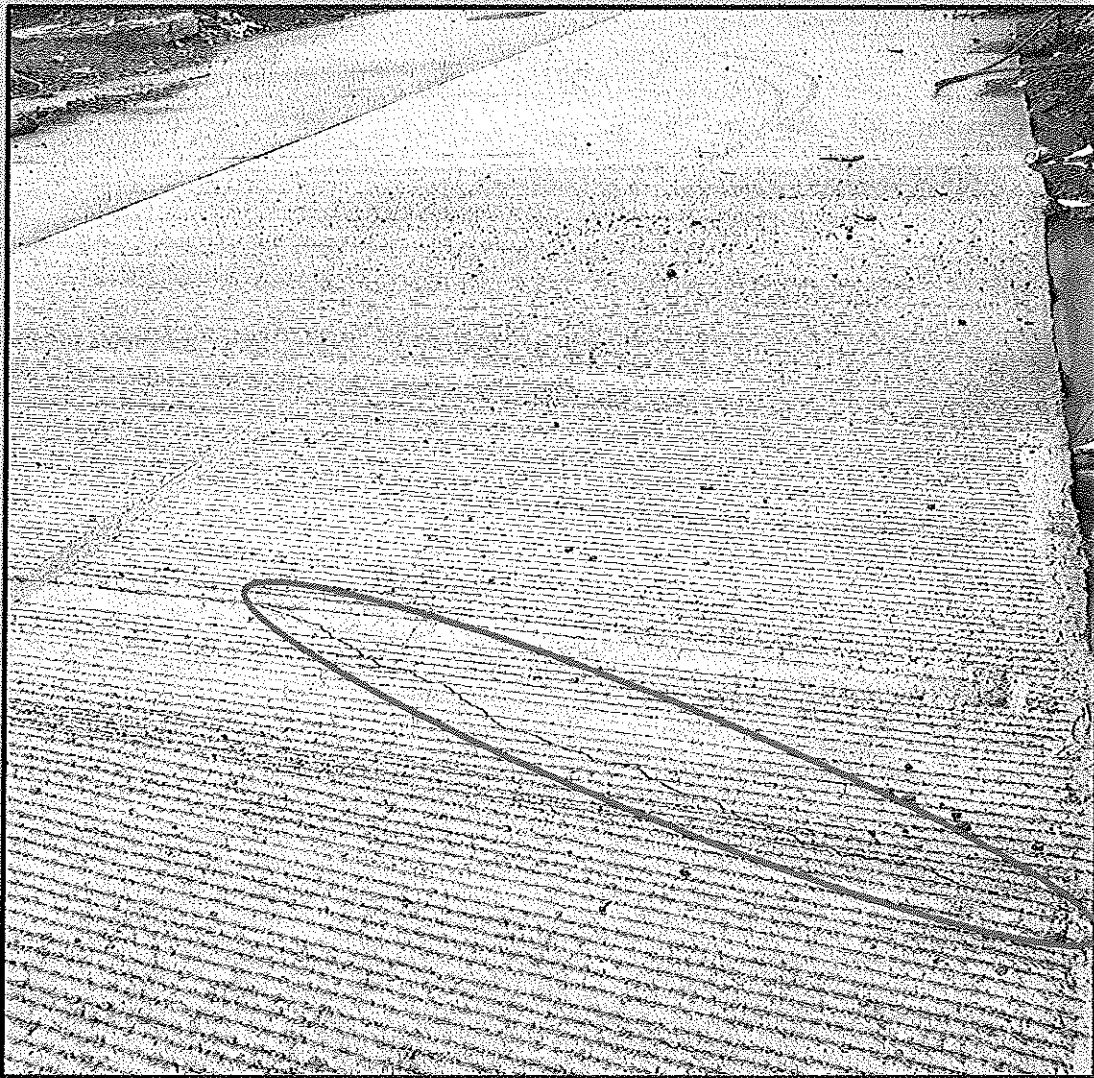
Fotos No. 3. Grieta de esquina por sobrecargas impuestas en tiempo no previsto en calle 95ª con Cra 103 esquina.
